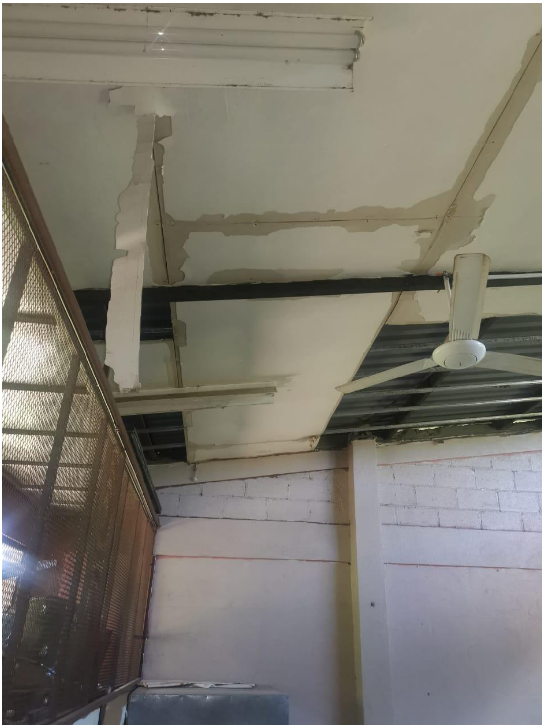
Estado actual de las aulas del Colegio Académico Playas del Coco
